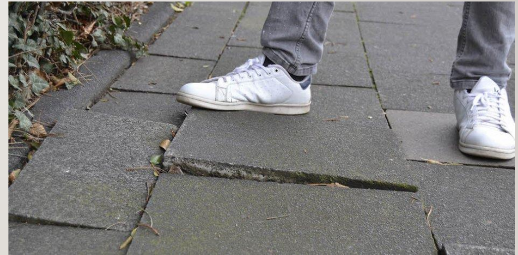
Stolperfallen auf Gehwegen
